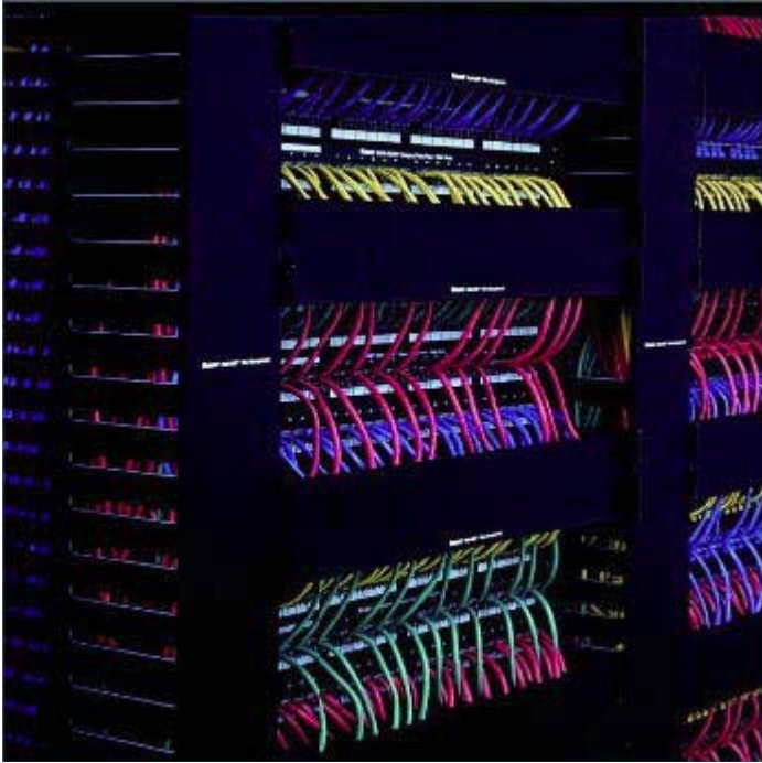
Figura 1 Sistema de administración de cable horizontal y vertical montado en bastidor
