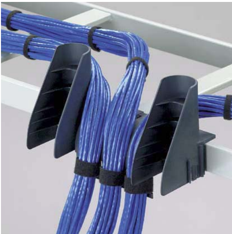
Figura 1 y 2 Administración de cables
